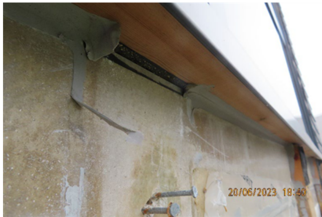
Afstandsliste demonteret og der er ikke fuget bag liste under vindue
